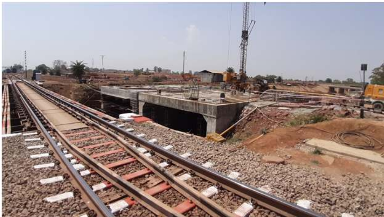
महानदी मुख्य नहर के कि.मी. 83.35 पर लखौली (आरंग) रेल्वे स्टेशन के समीप रेल्वे ब्रिज निर्माण कार्य
